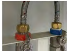
주방 싱크대 하부장을 열어 밸브 조절
